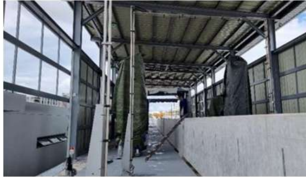
Máquina de lavado de trenes automatizada
