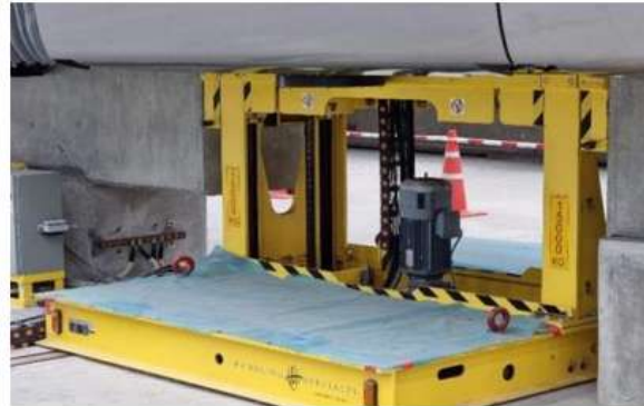
Estación de mantenimiento de bogíes (BMWS)
